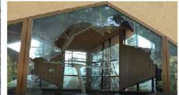
Una parte della vetrata della piscina in pezzi
